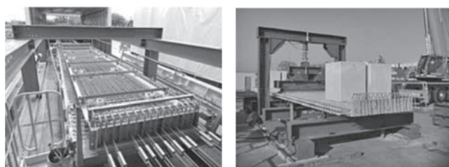
床版製作設備
