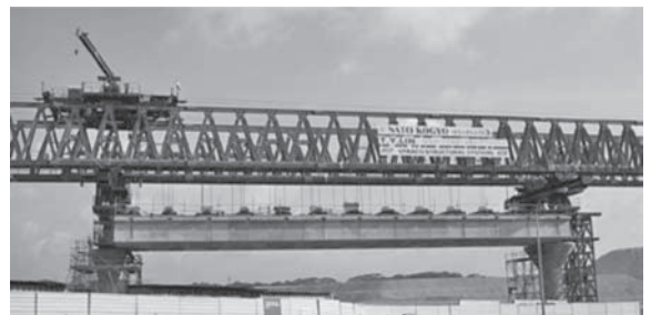
写真-12 道路橋のスパンバイスパン工法エレクションガーダー
