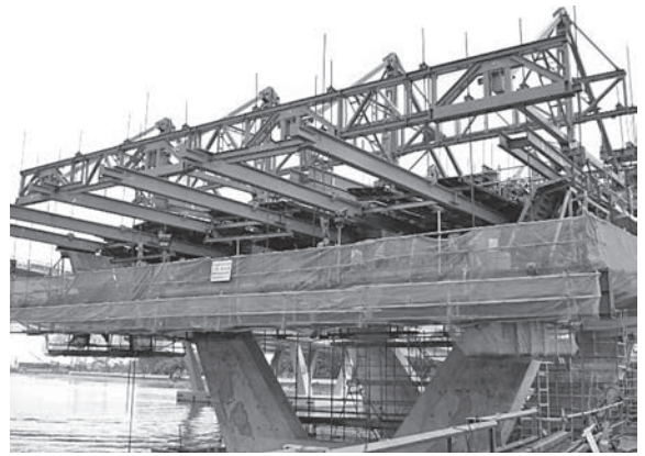
写真-11 道路橋の現場打ちバランスキャンチレバー移動型枠
