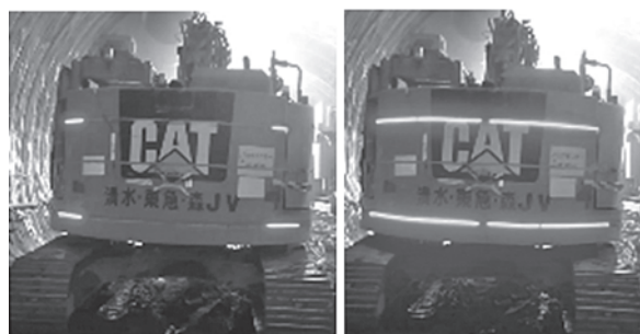
写真-6 シーケンシャルライト点灯状況
