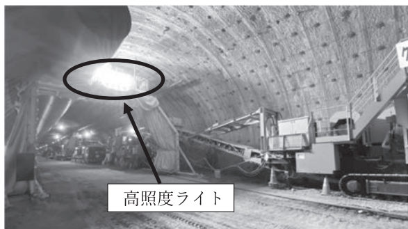
写真-3 照明架台と白色 LED 照明
