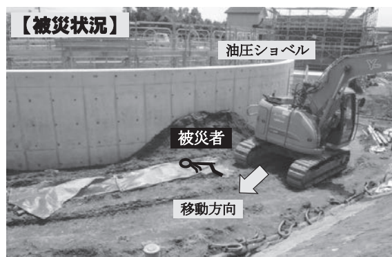
写真-1 油圧ショベルと作業員の接触事故
