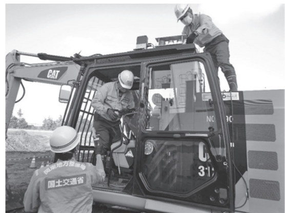
写真-2 簡易遠隔操縦装置（ロボQS）の設置
