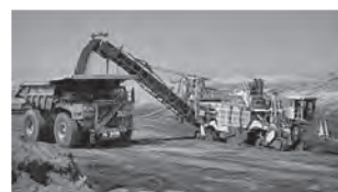
写真一23 Wirtgen 4200SM
