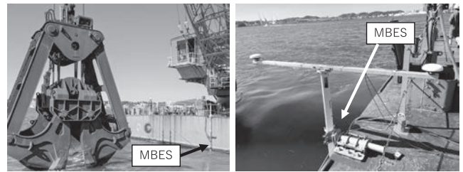
写真一2 MBES 施工管理システム設置状況 グラブ浚渫船：関門港湾建設(株) 関陽
