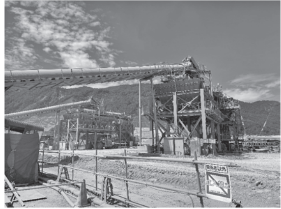
写真—7 CSG ダンプホッパー
