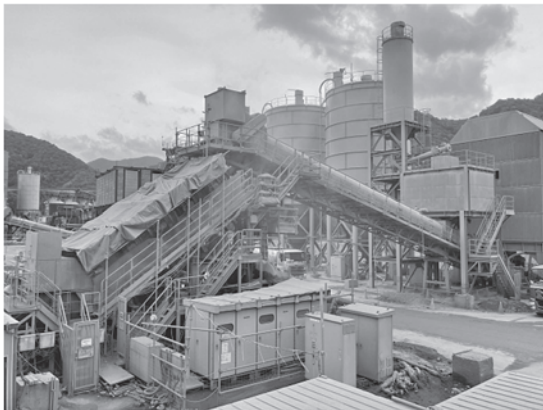
写真—6 CSG 製造設備
