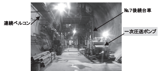
写真一六 一次圧送ポンプ
