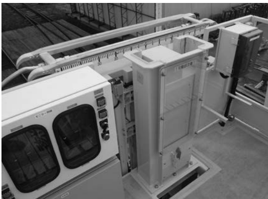
写真一七 架線検測装置
