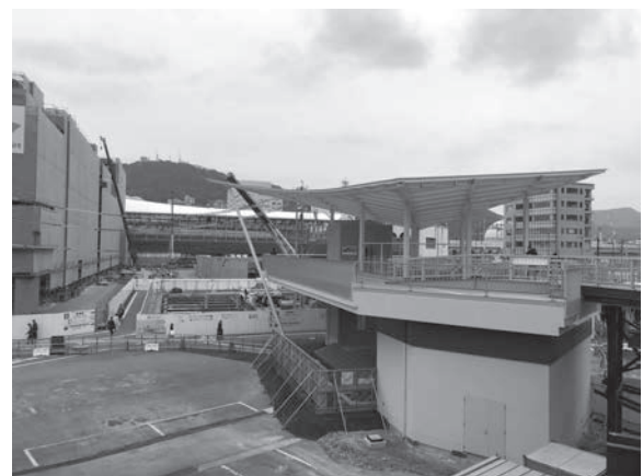
写真一 長崎駅周辺整備状況（2023.02 現在） （正面奥に見える施設が長崎駅（新幹線））
