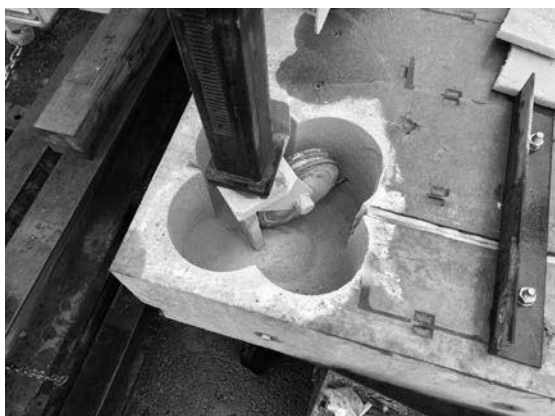
写真一七 コア孔 粉塵堆積状況
