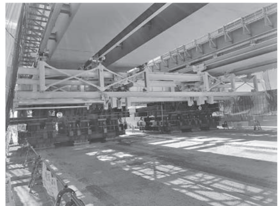
写真一5 サスペンションクレーン
