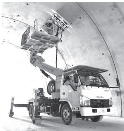
写真-1 本システムの外観
