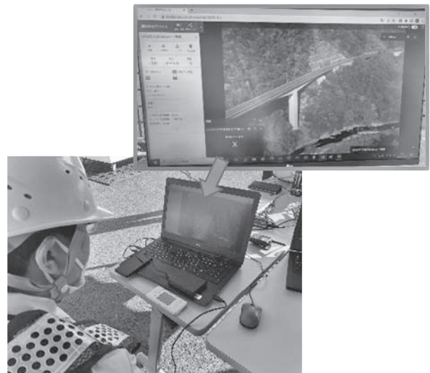
写真-4 リアルタイム監視状況
