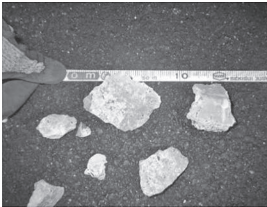
写真一 1 覆工コンクリートのはく落片の一例 3)
