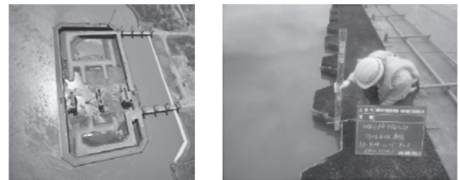
写真一2 出水時状況
