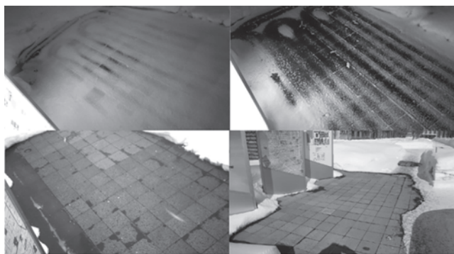
写真-3 循環・ヒートポンプ併用式システム 融雪状況
