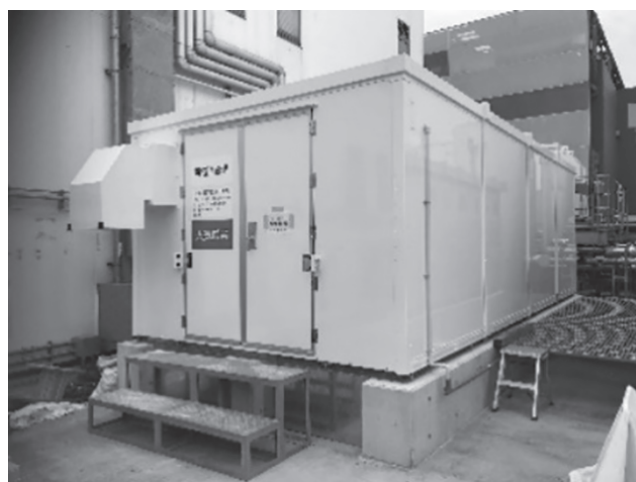
写真—2 蓄電池システム外観
