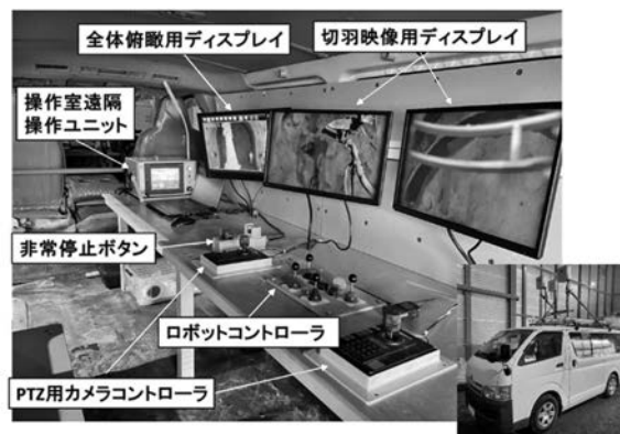
写真—2 操作室内部オペレータキャビン
