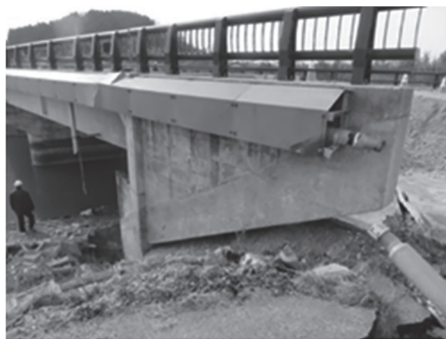
図—12 橋台背面部の損傷で抵抗特性が変化した事例
