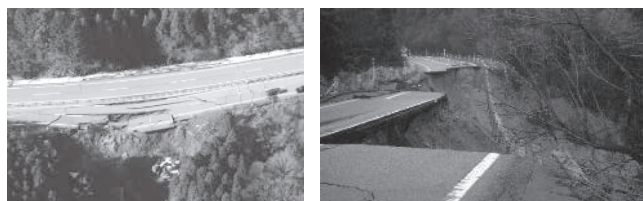
図—9 4車線区間（左）と2車線区間（右）の被災状況
