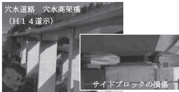
図一 4 新しい基準の橋の損傷例
