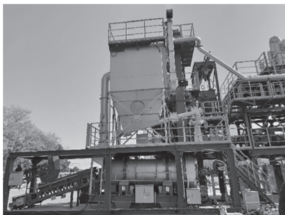
写真二 実験用アスファルトプラント
