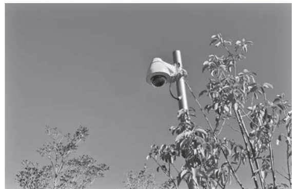
写真一2 ネットワークカメラの設置状況
