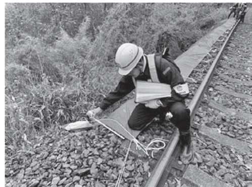
写真二 路盤の流出状況の測定
