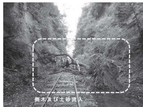
図-10 路盤部の被災状況(小湊鉄道)
