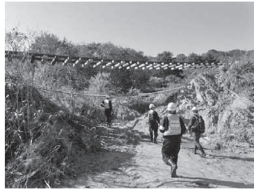
写真一 目視による被災現場の全体像の把握
