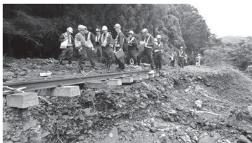
写真一三 調査の状況（路盤流出箇所）
