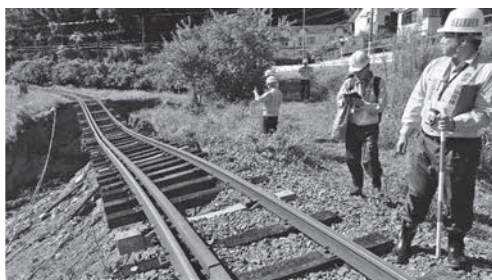
写真-4 路盤部の被災状況調査(いすみ鉄道)
