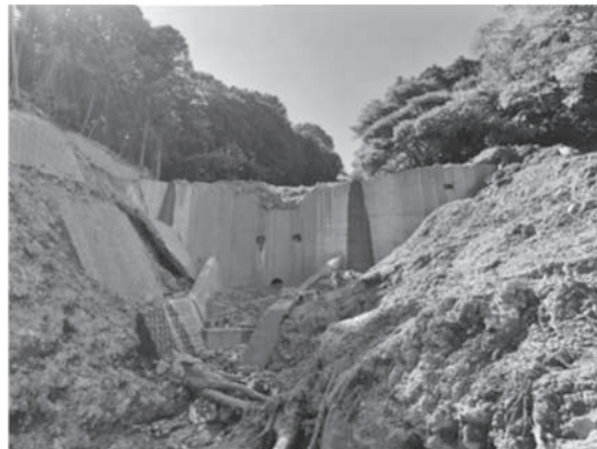
写真-1 被災状況 (既設砂防堰堤)
