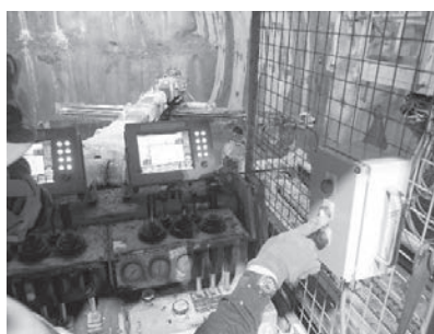
(e) 水圧制御ユニットのリモコン操作
