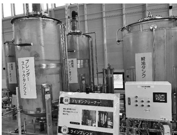
写真—5 軽油、重油との混合用設備
