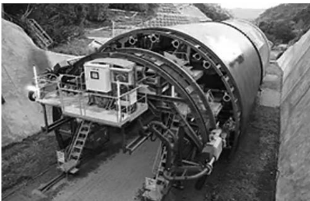
写真一 3 トンネル覆工コンクリート自動施工ロボットシステム
