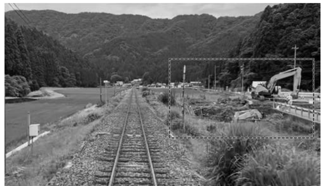
写真一6 近接工事の発見例
