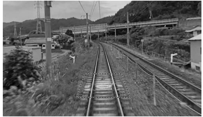
写真一4 噴泥・バラスト不足の例
