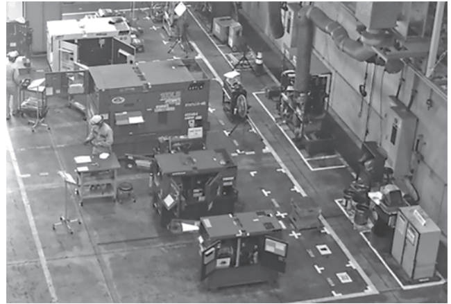
写真—3 整備中の発電機
