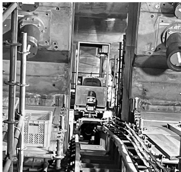
写真一七 緊張ジャッキ運搬台車
