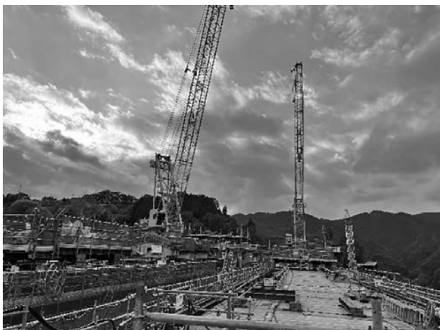
写真一五 トラベラークレーン
