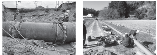
図一 上下水道システムの急所となる施設の被害状況 （左：送水管，右：処理場に直結する圧送管）
