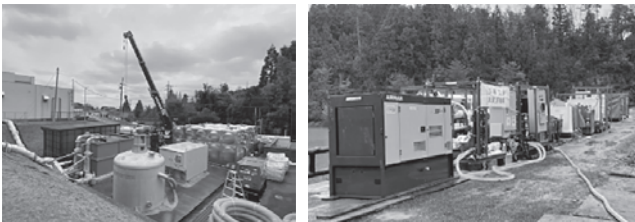
図一八 可搬式浄水施設・設備 設置事例
