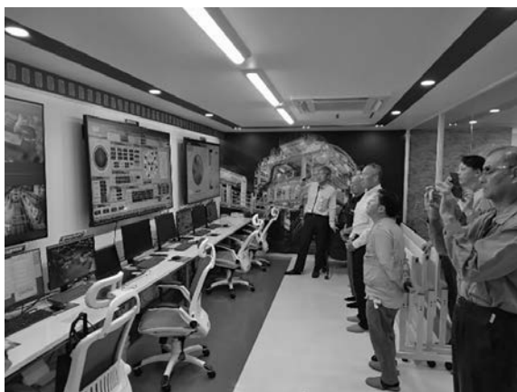
写真－8 モニタールーム
