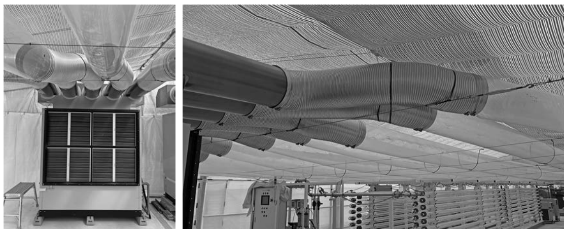
写真一3 GHP（ガスヒートポンプエアコン）
