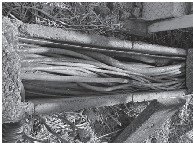
写真ー2 線路脇に敷設されている信号ケーブル
