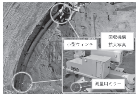
写真一3 ミラー回収機構
