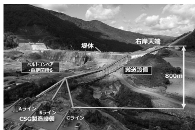
写真一2 搬送設備（プラント～右岸天端）
