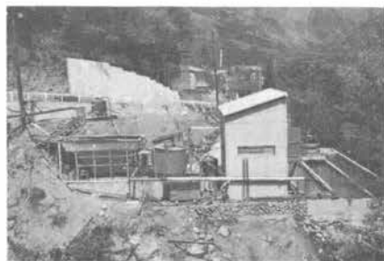
写真-1 濁水処理設備の全景
