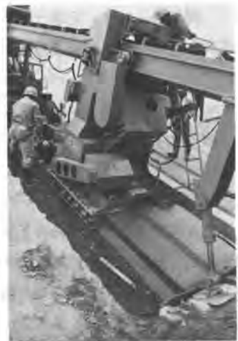
写真-2 スライディングフォームと打設コンクリート版面状況
