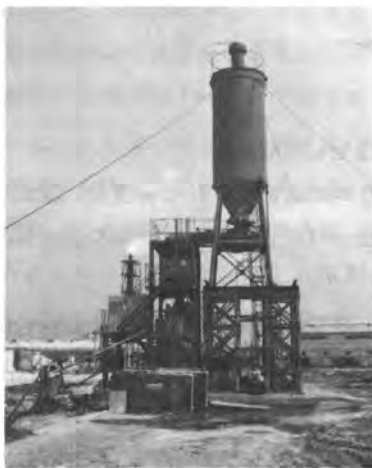
写-1 硬化材プラント
