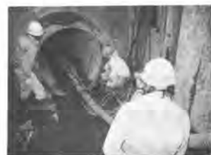
立坑部のフレキシブルホース
