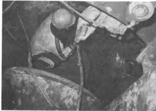
スクリューコンベア脱状況
