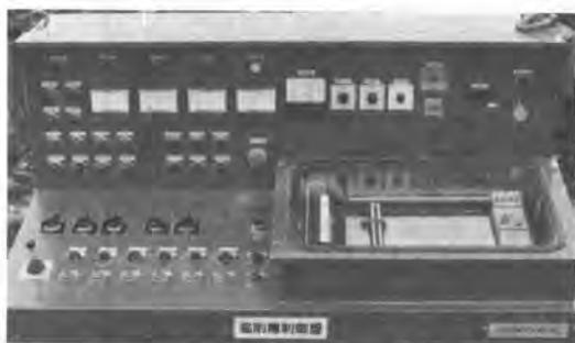
写真-2 T T 0 6 1 0 機制御盤
