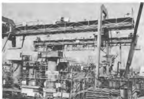
写真-1 装置の全景
