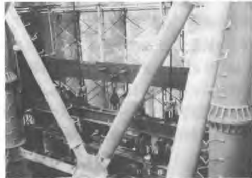
写真-3 押上げ装置
