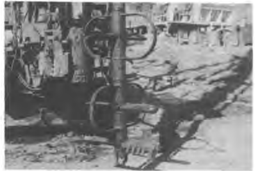
写真-1 攪拌装置
