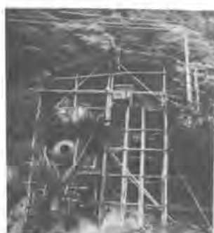
写真-1 現状プラント
