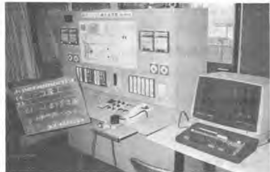
写真-2 コンピューター・システム
