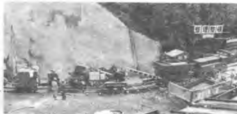
写真-7. 明神トンネル1号機(竣工)
