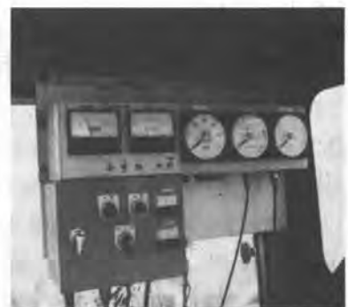
写真-3 運転室内の監視装置
