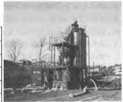
写真-2 スラリープラント(25m 3 /H)
