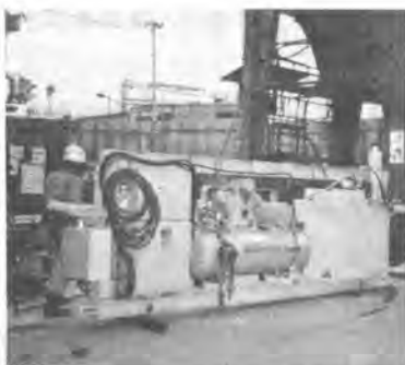
写真-2 起泡材作成設備（台車右側）
